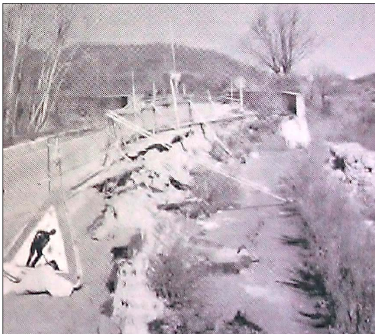
Fig. 74: La strada Malvitani-Santo Janni interessata da una frana dal luglio 1996 (R46/1998)
