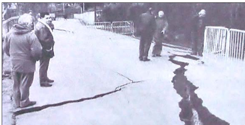
Fig. 35: Smottamenti sulla Provinciale 113 (R71/1995)
