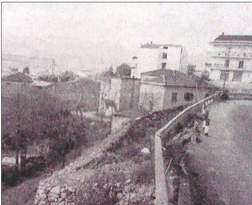
Fig. 40: La frana sulla SS 559 nei pressi dell'ex fornace (R102/1996)
