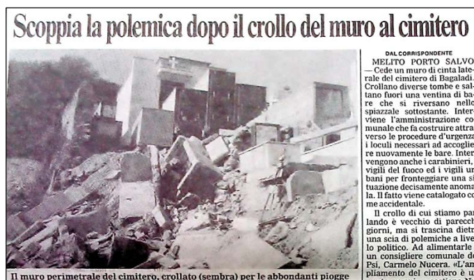
Fig. 23: Loculi danneggiati dal crollo del muro di cinta del cimitero (R61/1993)
