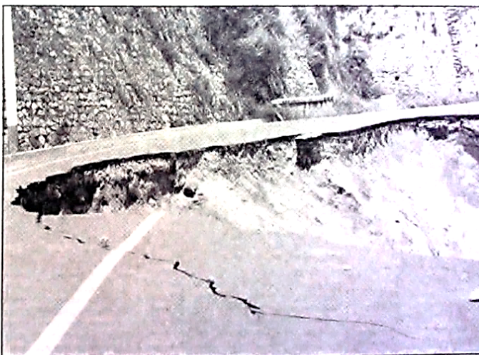
Il fronte franoso che ha interrotto la statale 19 nel centro di Tarsia
