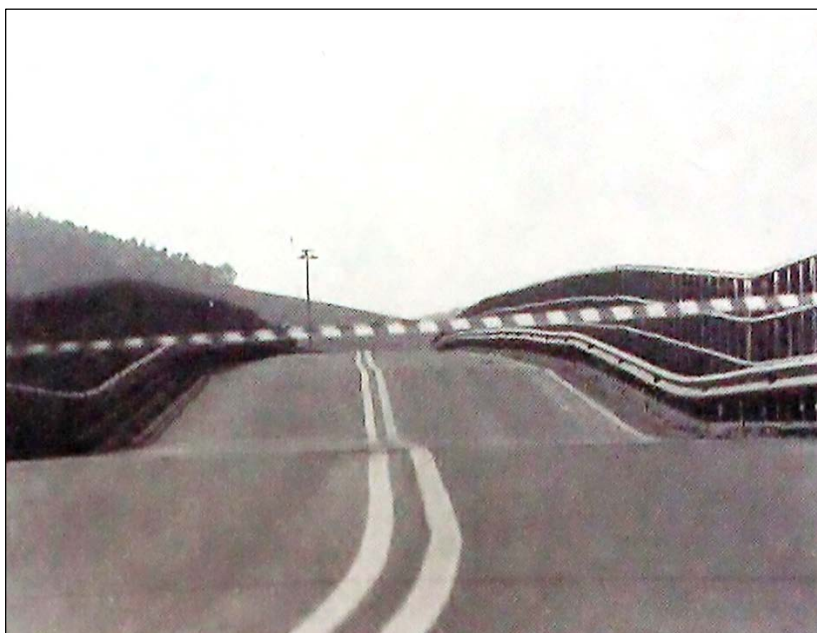
Fig. 45: Il cavalcavia nord della tangenziale, cedimento del pilone centrale (R180-181/1996)
