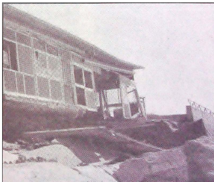
Fig. 88: I danni della mareggiata a Baja Video (R63/1999)
