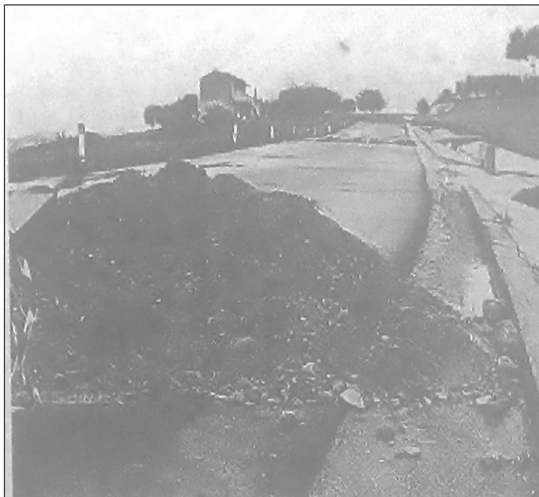
Fig. 58: La frana sulla strada provinciale a Muri (R11/1997)
