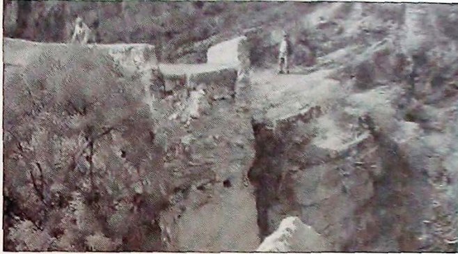
Quel che resta del Ponte del Diavolo, dopo il crollo di mercoledì (foto F. Arena)
