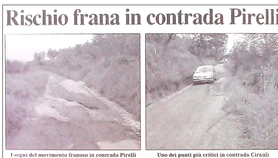
Fig. 73: La frana sulla strada comunale Pirelli-Santa Lucia (R45/1998)
