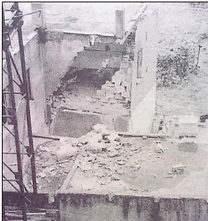
Fig. 6: Case danneggiate a Catanzaro (R78/1990)
