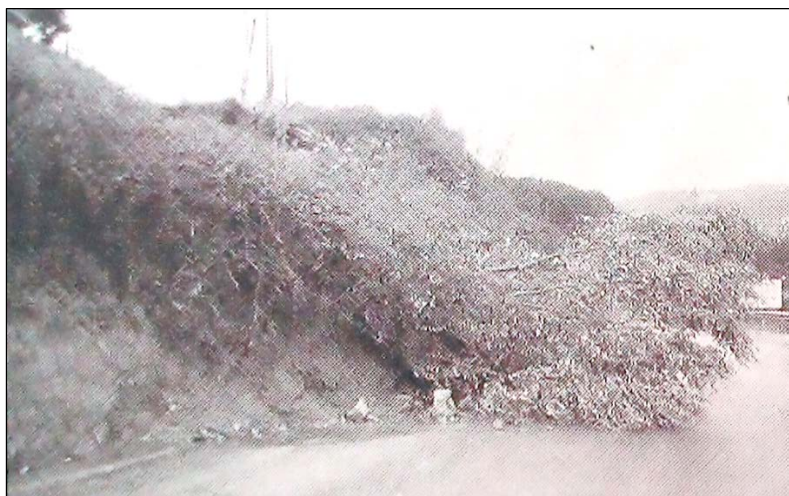
Fig. 82: La frana sulla strada che porta a Mendicino (R25/1999)
