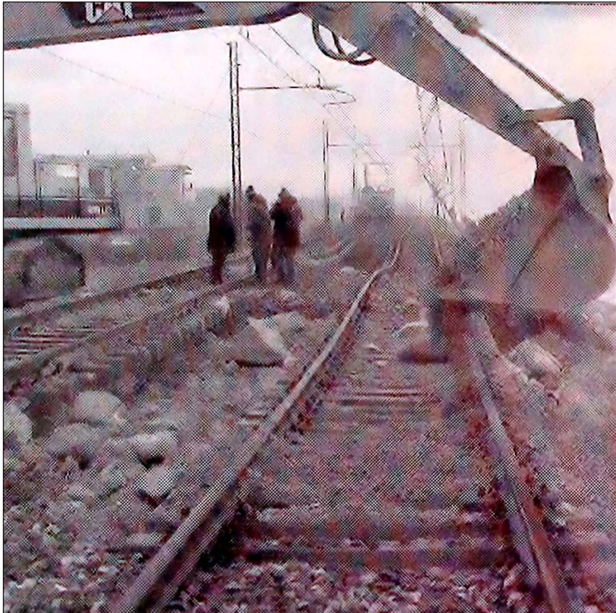
Fig. 103: Lavori di ripristino del tratto ferroviario tra Amantea e Campora distrutto dalla mareggiata (R162/1999)
