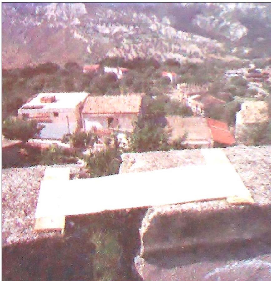
Fig. 71: Siderno, frana di contrada Larone, una crepa sul parapetto della strada (R36/1998)
